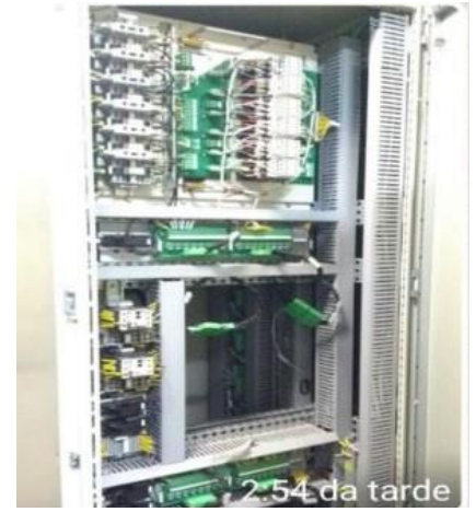
Gabinete de Terminação de Cabos
