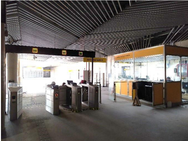
Bloqueios e comunicação visual em testes; Telecomunicações em comissionamento.
