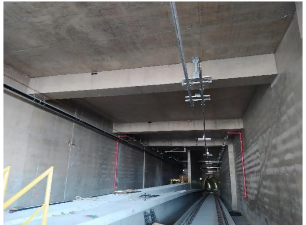
Rede Aérea instalada no túnel singular (Método NATM).
