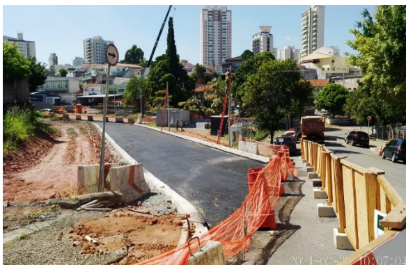
Estação Anália Franco – desvios de tráfego para execução das paredes diafragma do corpo da estação.
