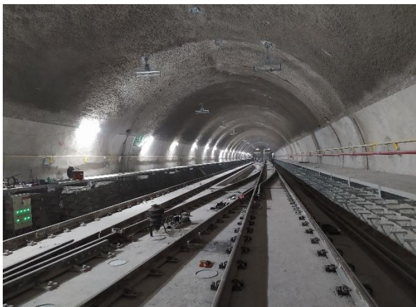
Túnel de Via 02 – Suporte da rede aérea e laje entre as vias em execução.
