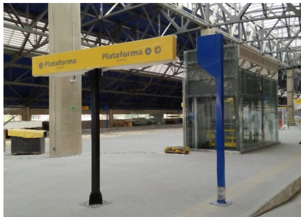
Nível Terminal de Ônibus – Comunicação Visual, infraestrutura de tomadas e de telecomunicações em instalação.
