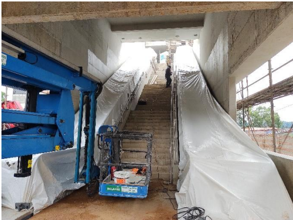
Obra Civil – montagem do corrimão e execução do acabamento; Sistemas – escadas rolantes posicionadas. (Acesso Norte)
