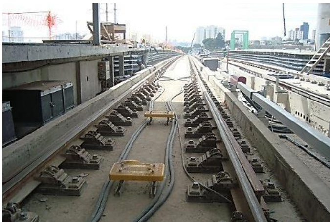
Equipamentos na via
