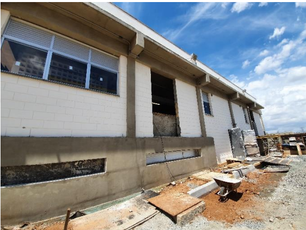
Obra Civil – execução do fechamento em esquadrias de vidro e metálica na sala de comando.
