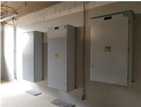
Sistemas; Vista de painéis
