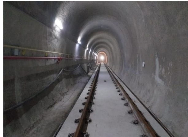
Túnel de Via 05 – laje flutuante e instalação de trilhos em execução. Trecho parcialmente concluído.
