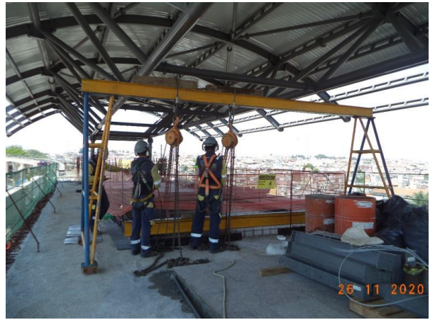
Obra Civil – instalação das telhas da cobertura da plataforma. Sistemas – posicionamento das escadas rolantes.
