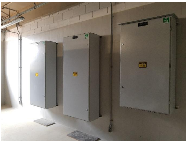
Sistemas; Vista de painéis
