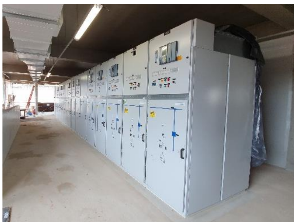
Obra Civil – execução do acabamento, montagem dos dutos de ventilação, infraestrutura de iluminação e tomadas e cubículos da Sala de
