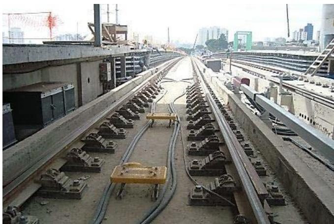
Equipamentos na via
