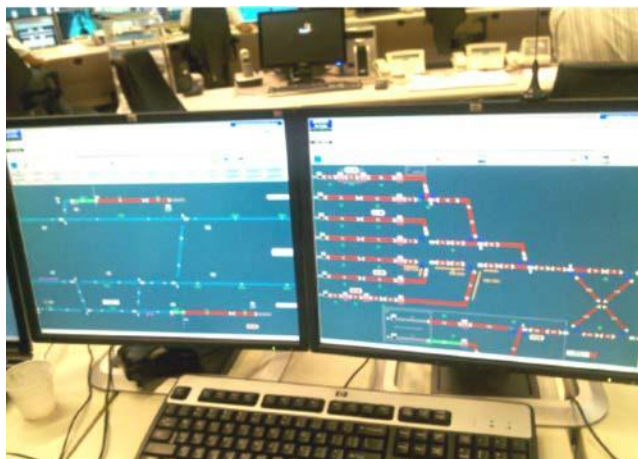
Painel de controle de tráfego
