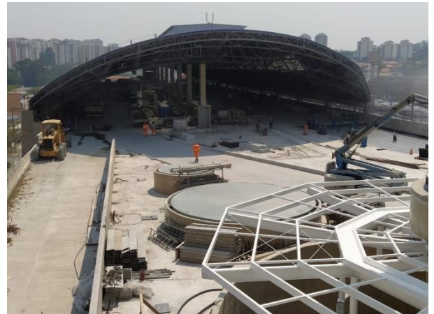
Nível Terminal - execução do pavimento rígido e piso na plataforma de ônibus.
