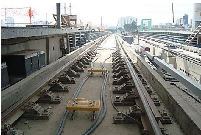
Equipamentos na via
