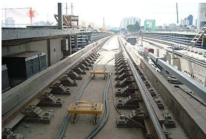
Equipamentos na via
