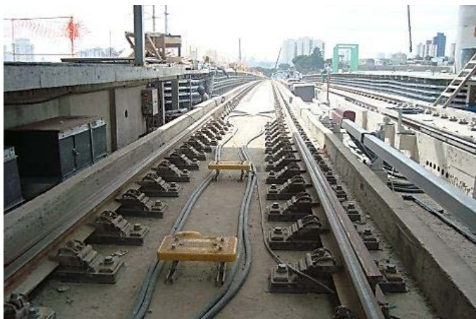
Equipamentos na via
