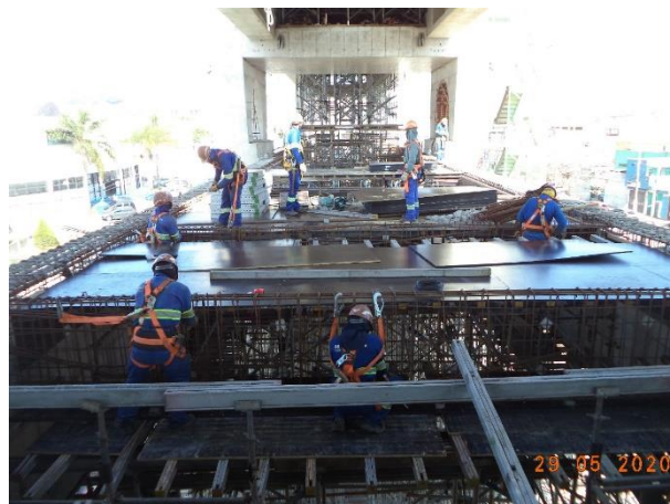
Obra Civil – Em montagem o cimbramento, formas e armação da laje do mezanino.
