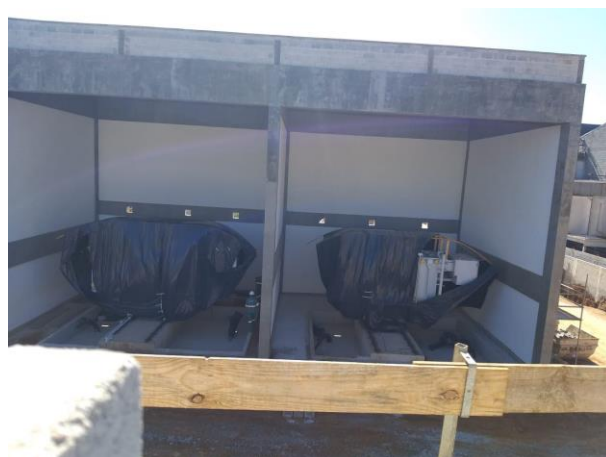
Transformadores de alta tensão entregues.
