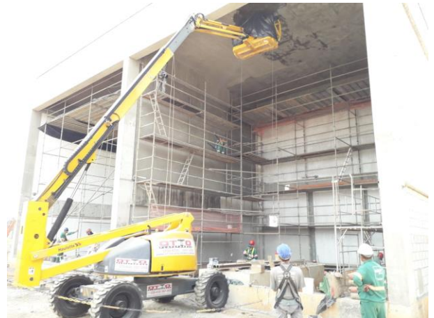
Obra Civil – laje de cobertura e alvenaria de fechamento da sala de transformadores concluídas.
