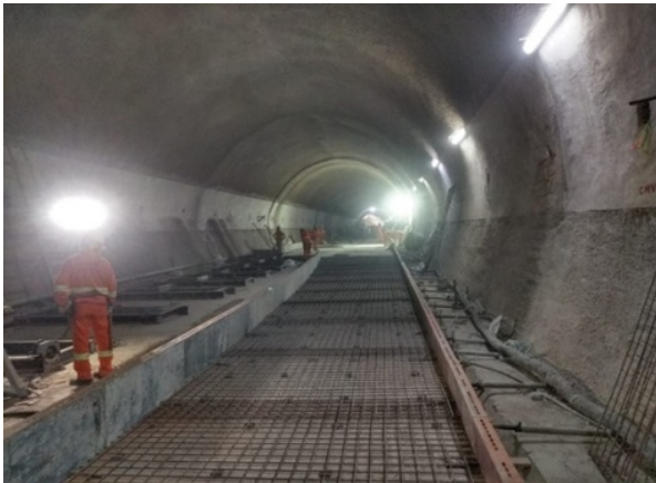
Túnel de Via 07 – laje de regularização para as vias permanentes em execução.
