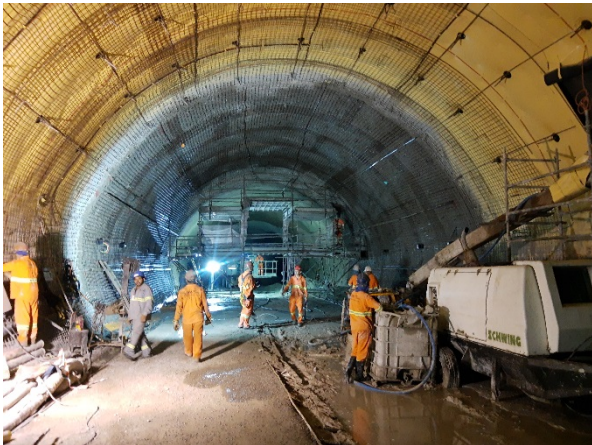
Túnel de Via 02 - em execução a armação para o revestimento secundário da calota.
