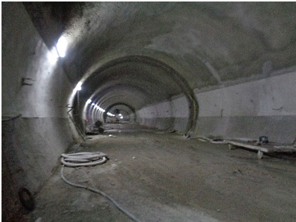
Túnel de Via 04 - em execução a impermeabilização e o revestimento secundário da calota.
