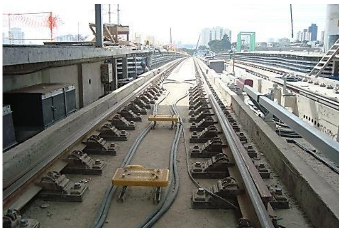
Equipamentos na via
