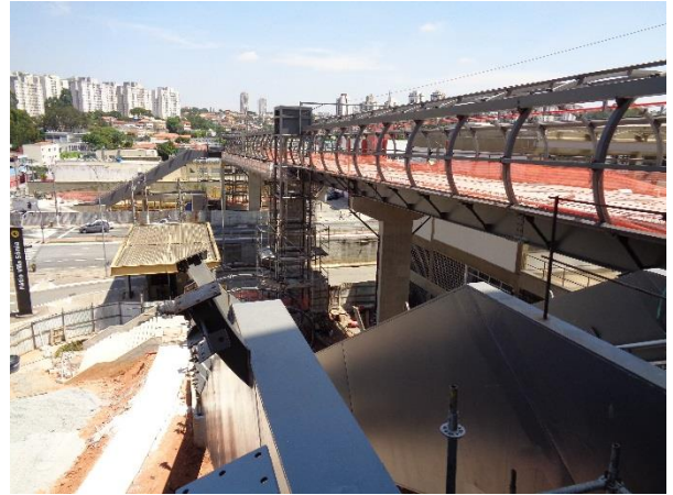
Execução da passarela e escada dos Acessos Heitor dos Prazeres e Eliseu de Almeida.
