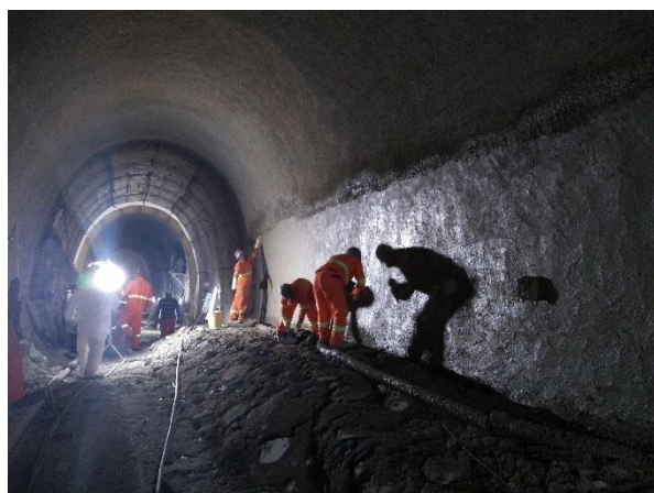
Túnel de Via 05 - em execução o revestimento secundário da calota; trechos de túnel singelo Pátio e Poço de Serviço Valter Seng conectados.
