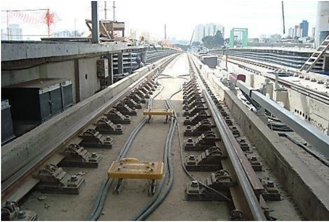
Equipamentos na via
