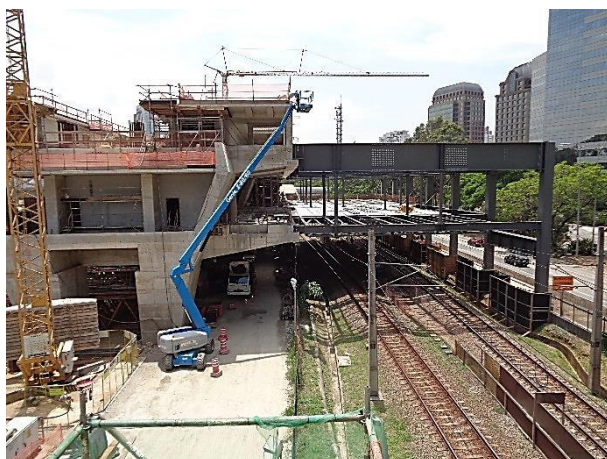
Corpo da Estação – Lajes da plataforma e interligação com CPTM em andamento.
