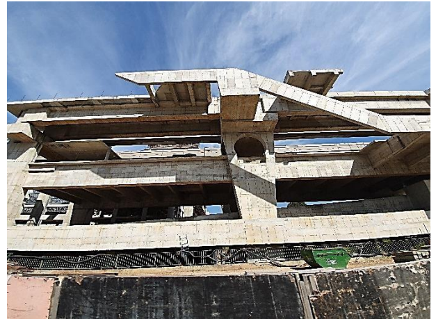
Corpo da Estação – Obra bruta concluída. Em fase de recontração das obras complementares.
