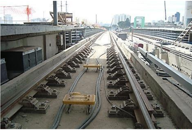
Equipamentos na via
