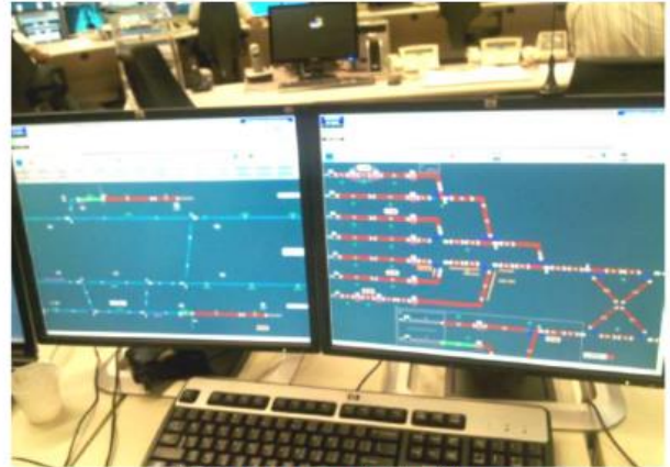
Painel de controle de tráfego
