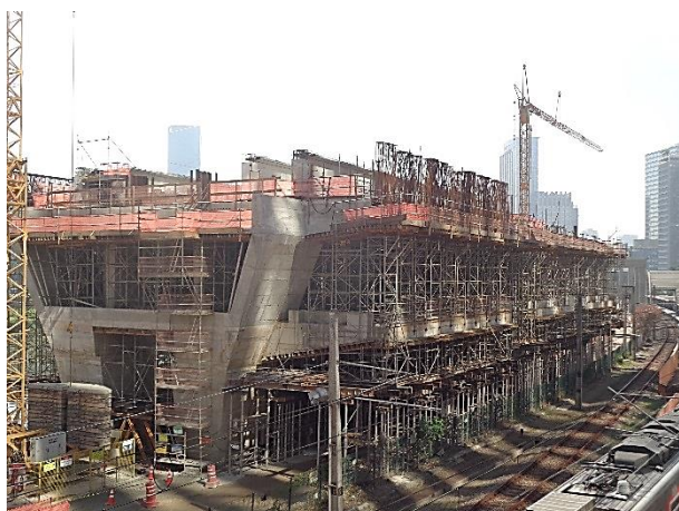
Execução das vigas na área do porão de cabos/ viga de apoio das plataformas.
