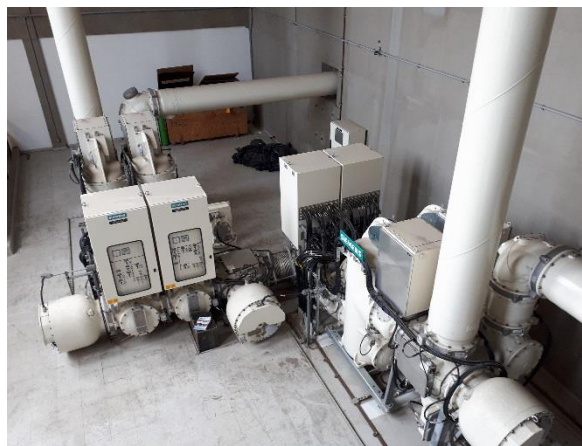
Detalhe da Subestação Isolada a Gás (GIS).
