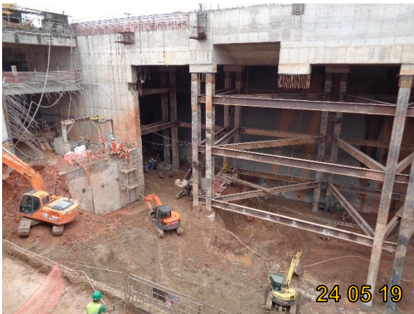
Corpo de Estação: Escavação sob a laje de cobertura da estação pelo Acesso Heitor dos Prazeres.
