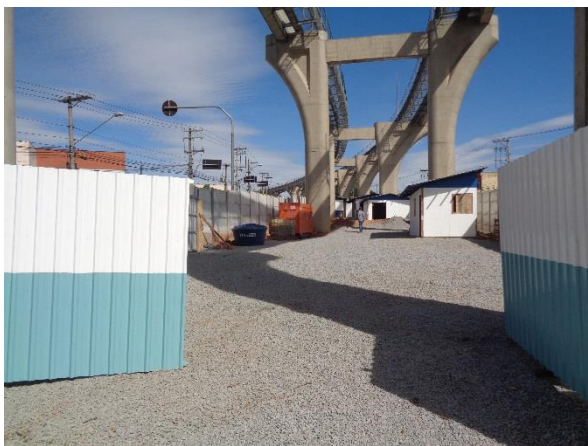
Instalado o canteiro de obra/civil da contratada Somague Engenharia S/A do Brasil
