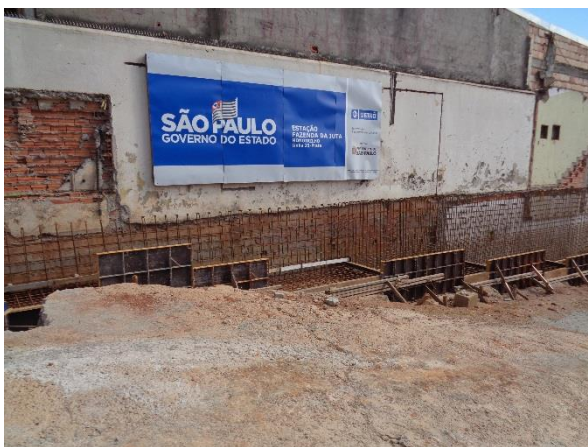
Obra Civil – execução do muro de contenção do Acesso Norte e implantação dos Sistemas.
