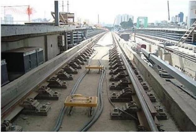
Equipamentos na via
