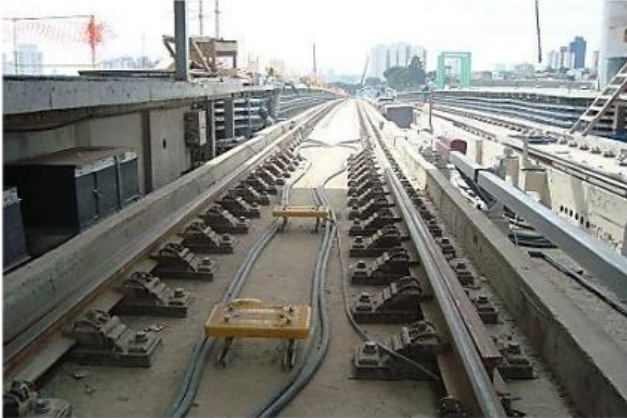
Equipamentos na via
